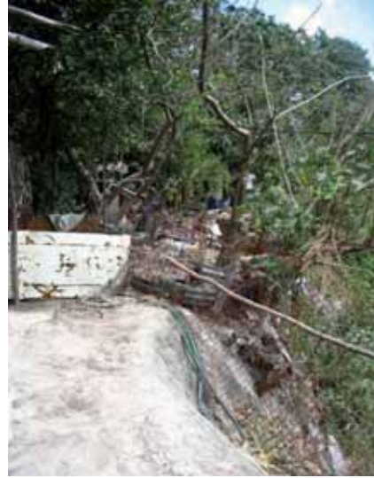
Vivienda en limite de ladera. Descarga de agua
