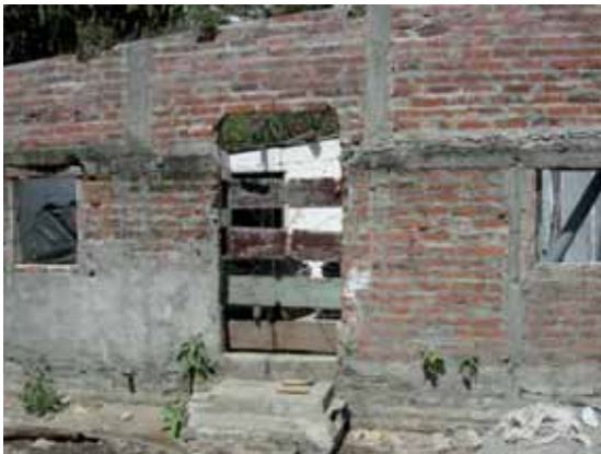
Estructura vivienda abandonada
