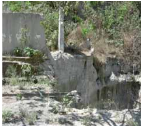
Estructura vivienda colapsada terreno constante erosión por tipo material tierra blanca
