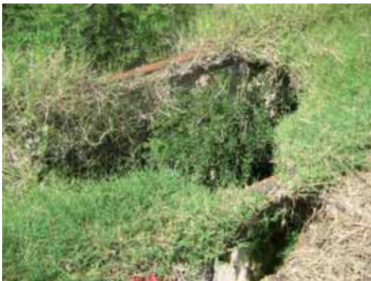
Estado actual de tramo línea férrea
