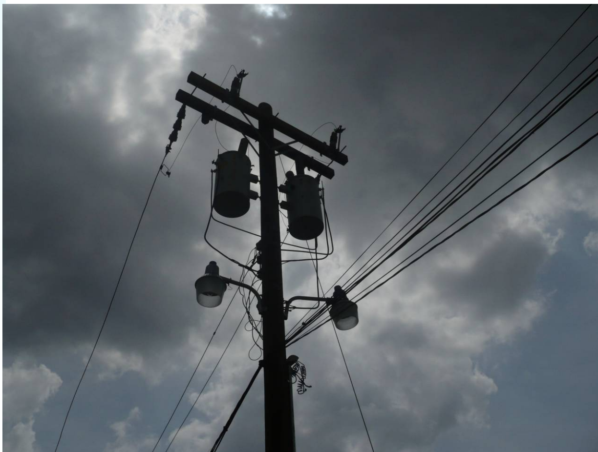
Poste con los transformadores: A la izquierda podemos ver el cable que va hacia la caja de control.
