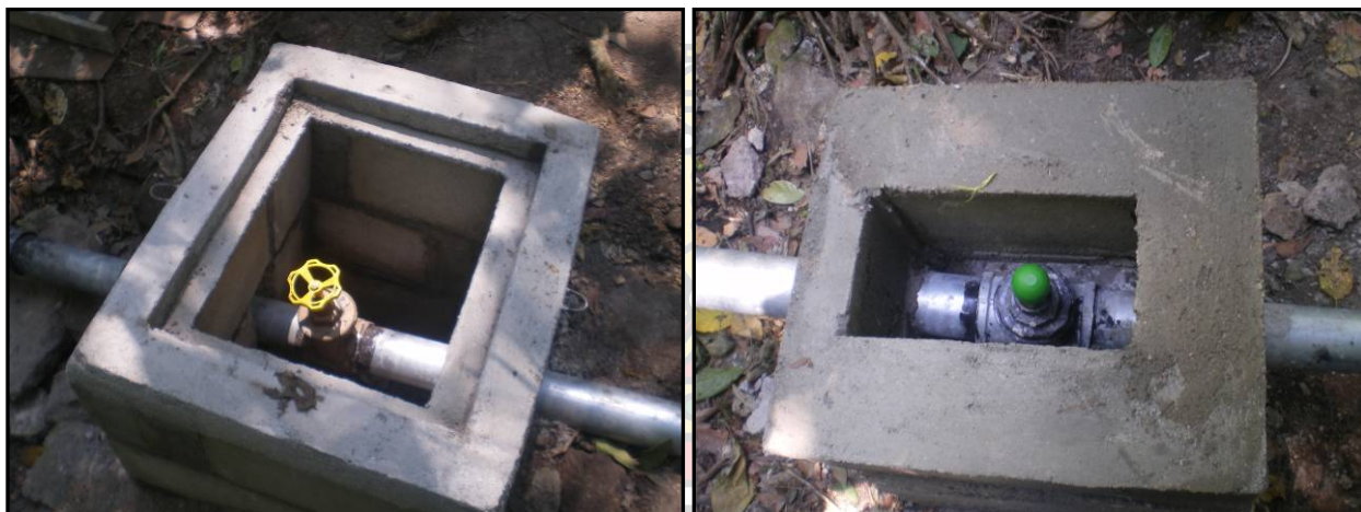
Izquierda: Válvula de compuerta. Derecha: Válvula de aire
