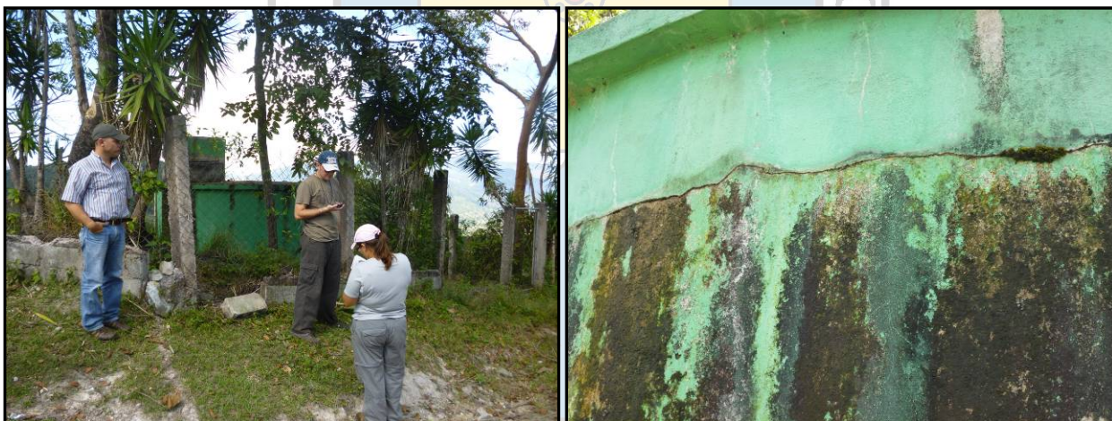
Izquierda: Predio con los tanques de la comunidad. Derecha: Grieta en la pared del tanque de 6000 galones
