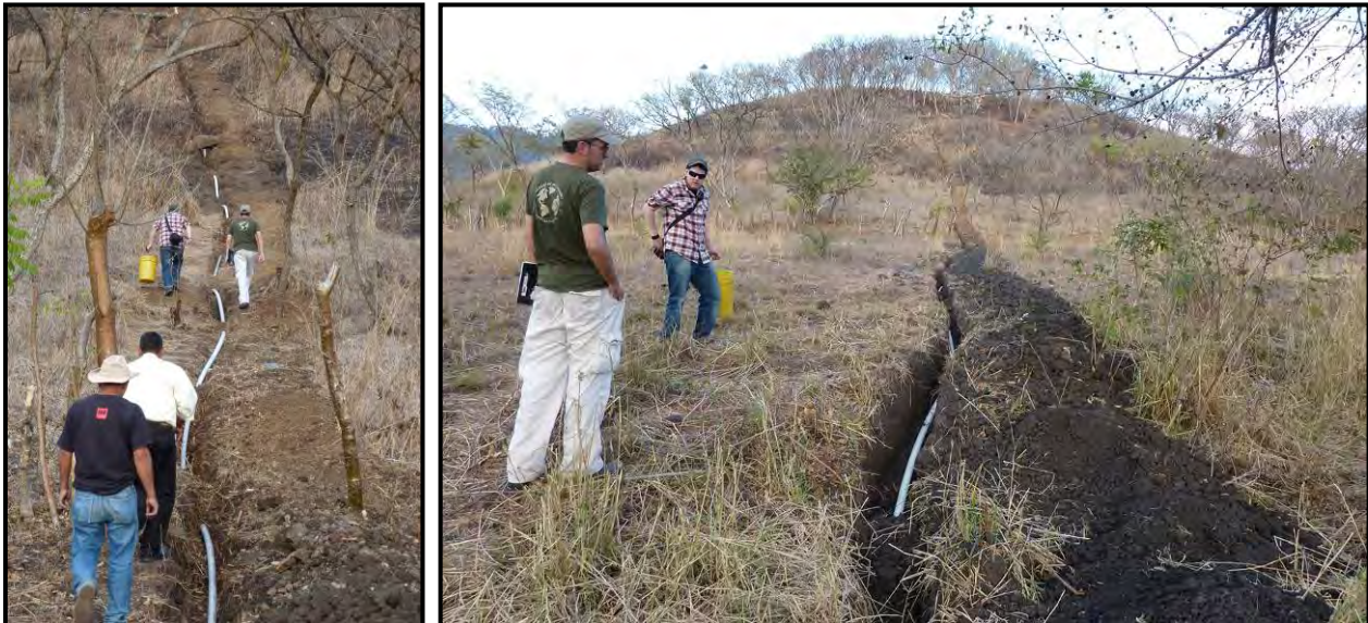
Imágenes 69 y 70: Izquierda: Camino al tanque con la tubería ya instalada. Derecha: Detalle de las tuberías en la zanja.
