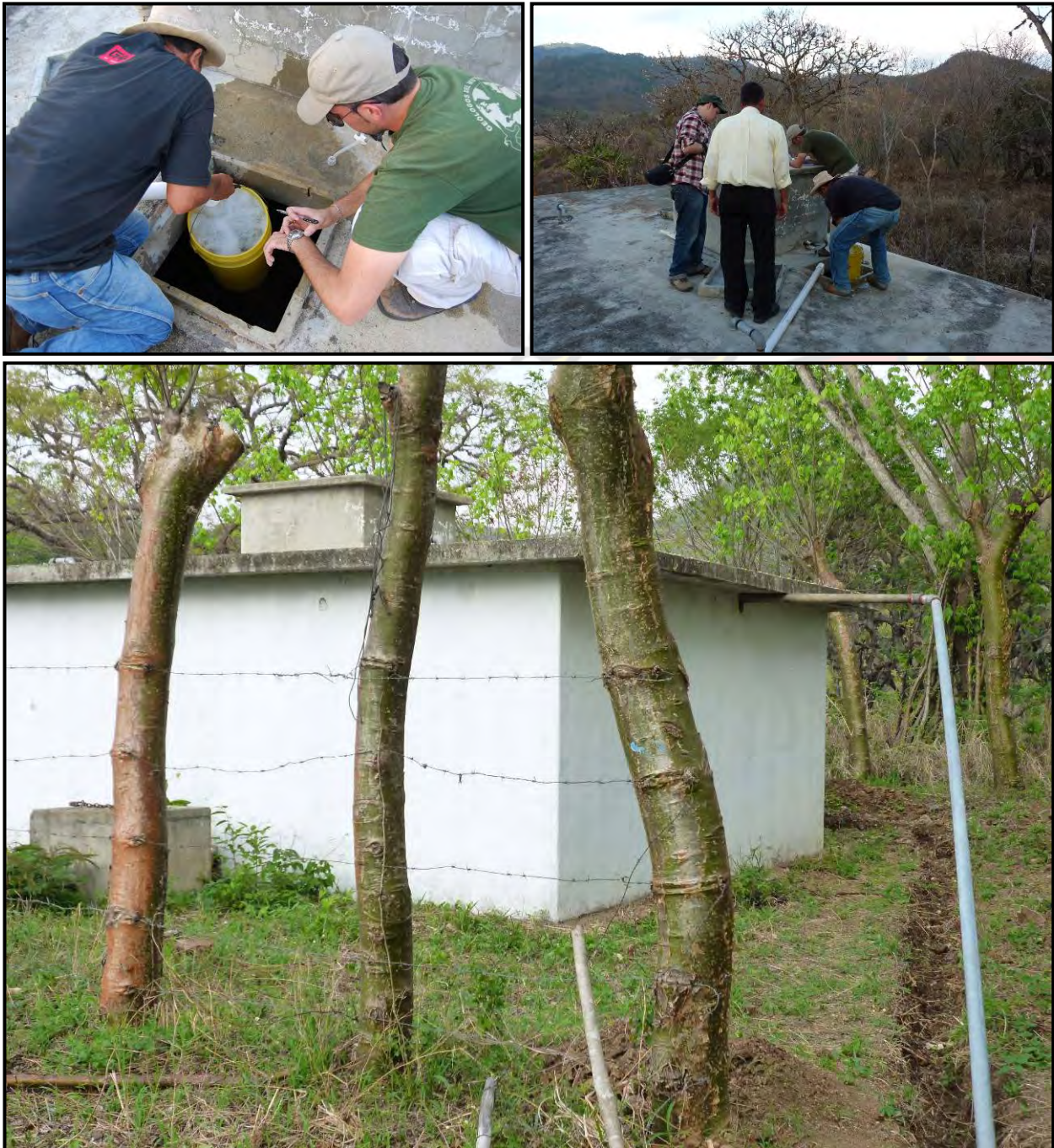
Imágenes 71, 72 y 73. Izquierda: Medida del caudal en el tanque. Derecha: Realización de la prueba de aforo ante la tubería impelencia. Abajo: Conexión con el tanque, aunque la conexión definitiva se realizará posteriormente.
