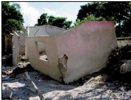
Fig. 23. Vivienda afectada en ribera del río Champezote.
