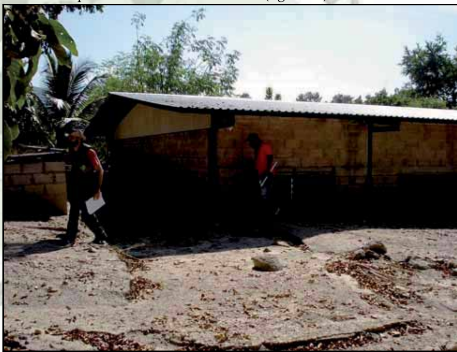
Fig. 31. Vivienda parcialmente sepultada por los materiales de la colada.
