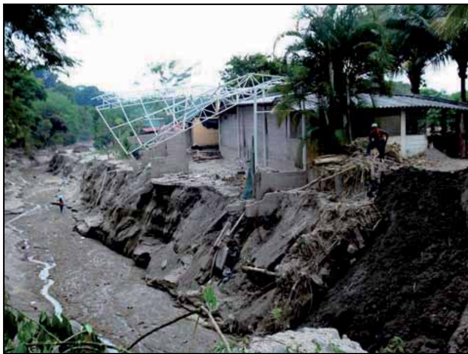
Fig. 36. Imagen de vivienda afectada por la quebrada en las proximidades de la calle al Cantón El Sauce.
