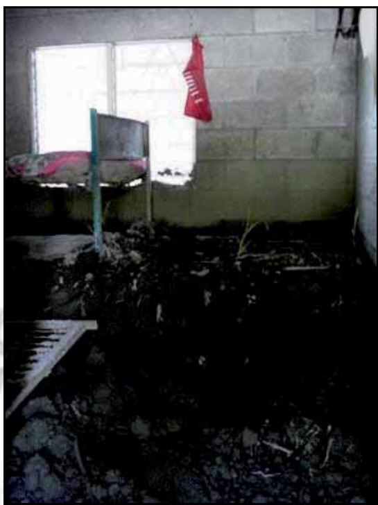
Fig. 25. Casa azolvada en las proximidades de la zona de desembocadura. Pto 78.
