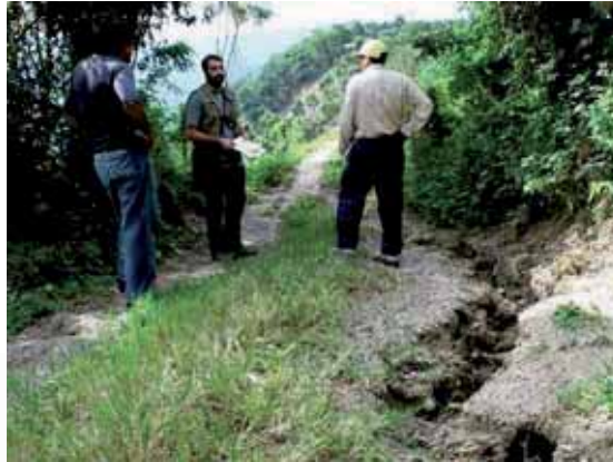
Fig. 7. Grietas observadas. (GPS 047)
