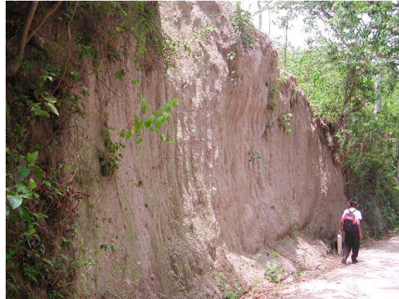
Fotografía 6.14.- Depósitos en la base del talud desprovisto de vegetación. Cantón el Guaje.
