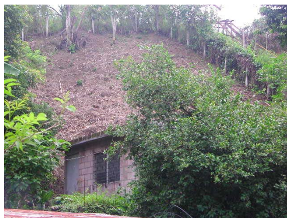
Fotografía 6.10.- Deslizamiento traslacional. Cantón El Porvenir. Desencadenante las precipitaciones.
