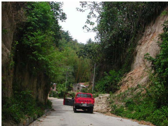
Fotografía 6.15.- Calle flanqueada por taludes verticales con fenómenos de inestabilidad. El Porvenir.
