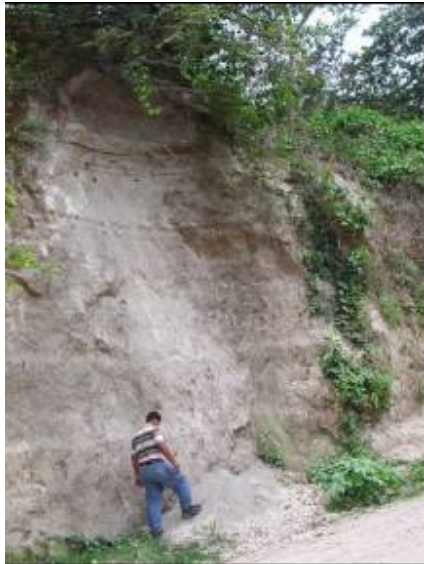
Fotografía 6.12.- Desprendimientos en talud abierto en carretera del cantón El Porvenir.
