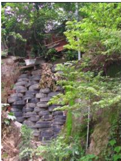
Fotografía 7.10.- Medidas de sujeción del talud bajo vivienda mediante neumáticos. Casco Urbano Cantón Chaltepe..
