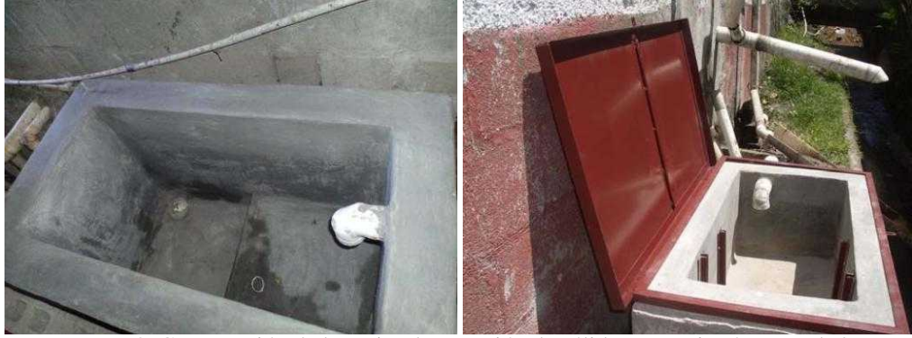
Figura 8: Construcción de las cajas de retención de sólidos que evitarán parte de la contaminación del lago.
