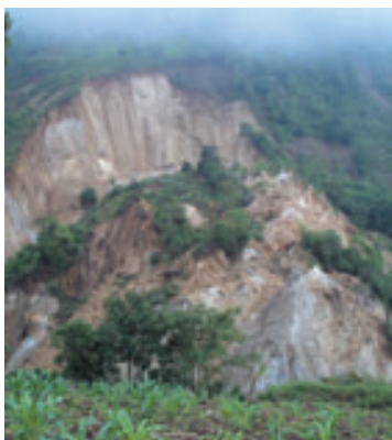
Deslizamiento del Cerro Lec
