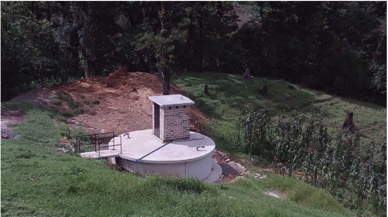
Imagen 3: Cisterna de bombeo con la caseta de control de la bomba.
