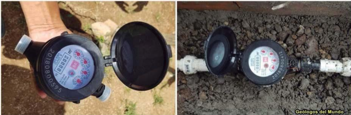
Figura 37.- Micromedidores instalados en las acometidas domiciliarias. En total fueron instalados 76.
