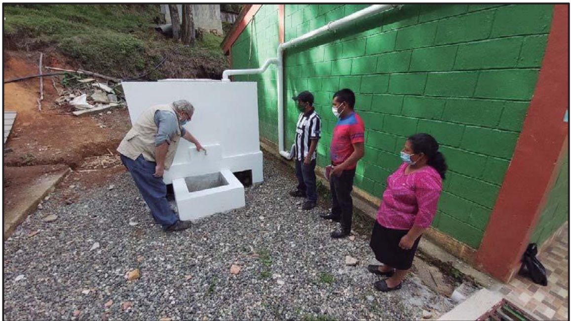
Imágenes 11 y 12: Sistema de recogida y aprovechamiento de aguas lluvia.
