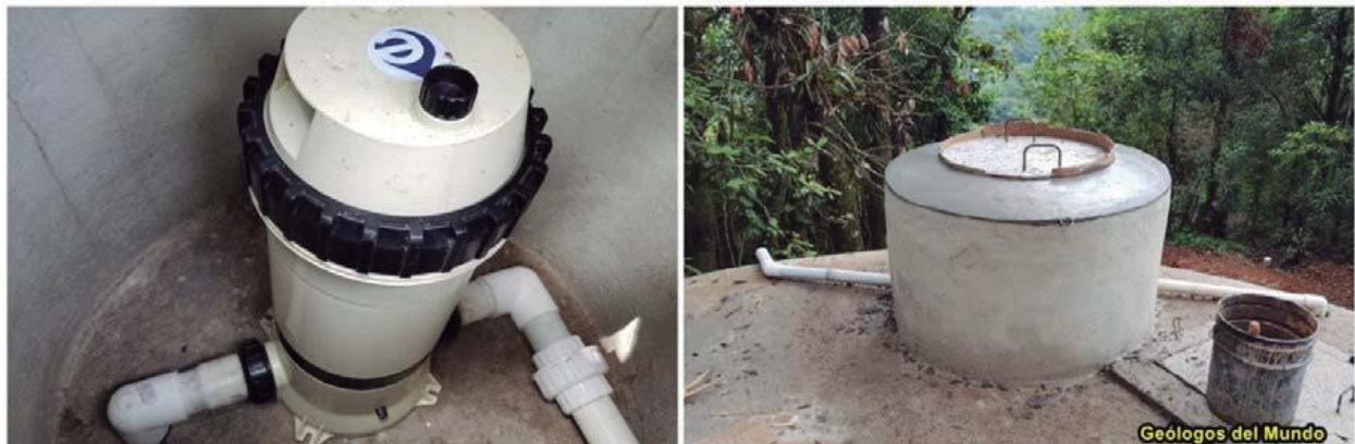
Figura 31.- Elemento desinfección consistente en un clorador por tableta conectado en la entrada de agua al depósito, y su correspondiente caja de protección.
