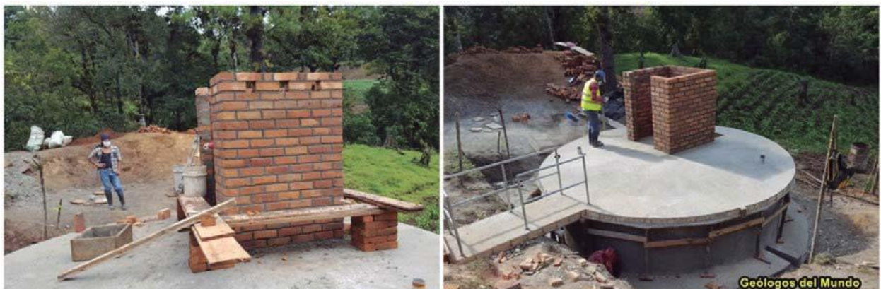
Figura 22.- Construcción de la caseta de protección de los controles eléctricos de la bomba y de la propia bomba.
