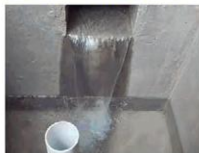
Captación de agua en manantial.
