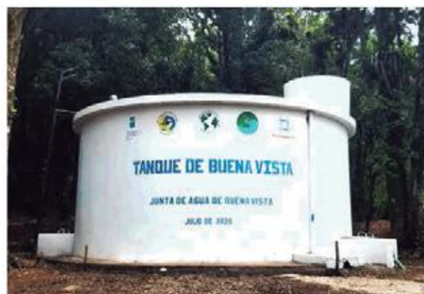
Depósito de almacenamiento (37.854 litros)
