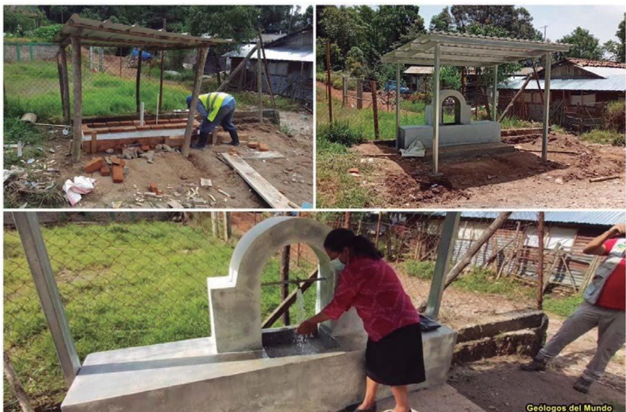
Figura 32.- Construcción de la fuente comunitaria y su puesta en servicio. El lugar elegido por la comunidad fue en la calle principal. Para proteger del sol y la lluvia a los usuarios mientras realizan el acopio de agua, se instaló una marquesina muy elemental de protección
