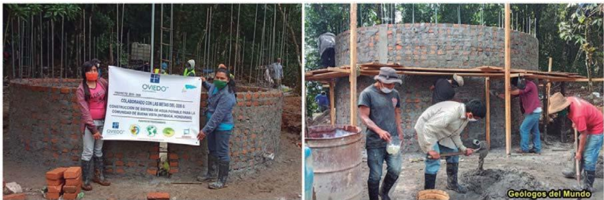
Figura 29.- Dos momentos de la construcción de la pared, que posteriormente serán repelladas interior y exteriormente. Tanto ladrillos como el mortero impermeabilizados por aditivos.
