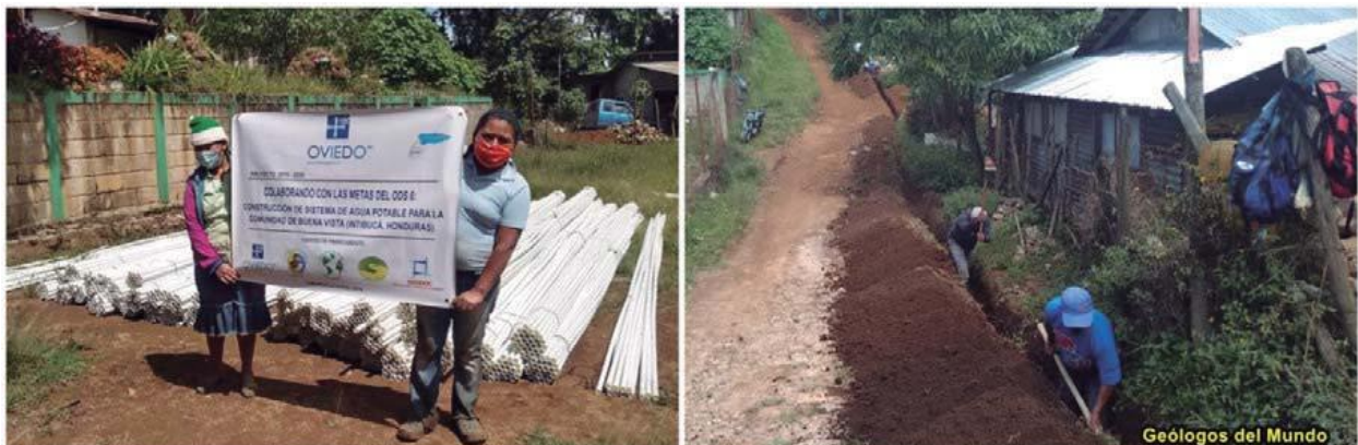
Figura 33.- Acopio de tubería PVC para el sistema de distribución y acometidas domiciliarias. Labores de zanqueo.
