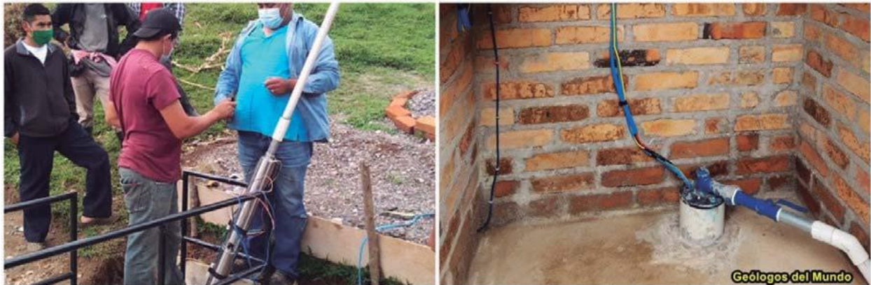
Figura 23.- Bomba sumergible en proceso de instalación, y tren de descarga con la bomba ya instalada-
