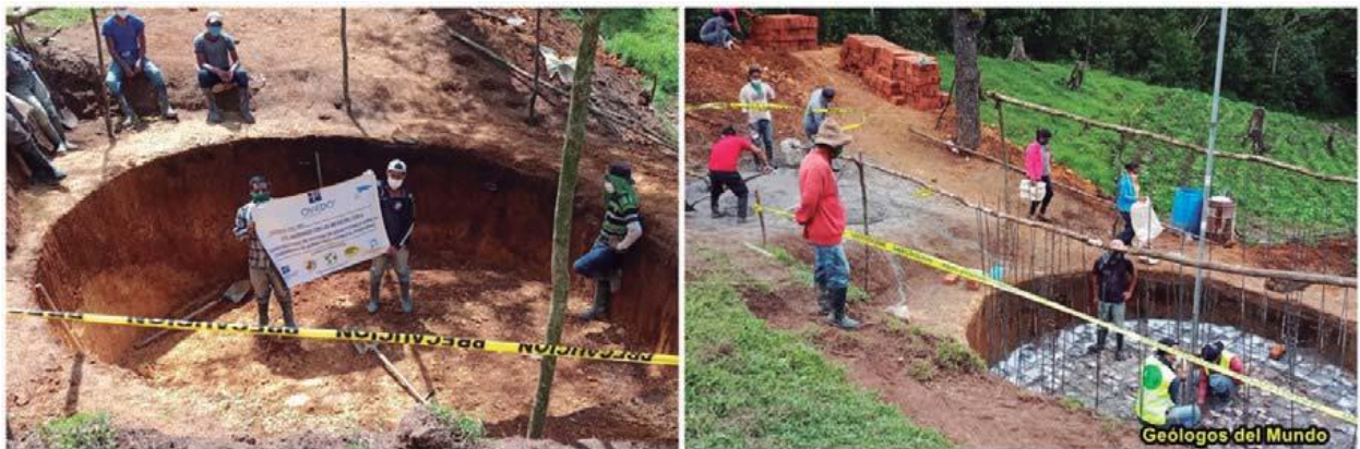
Figura 19.- Excavación en rasante de cimentación, y cimentación con losa de hormigón ciclópeos; se puede observar también el armado vertical que irá incluido dentro de las paredes.
