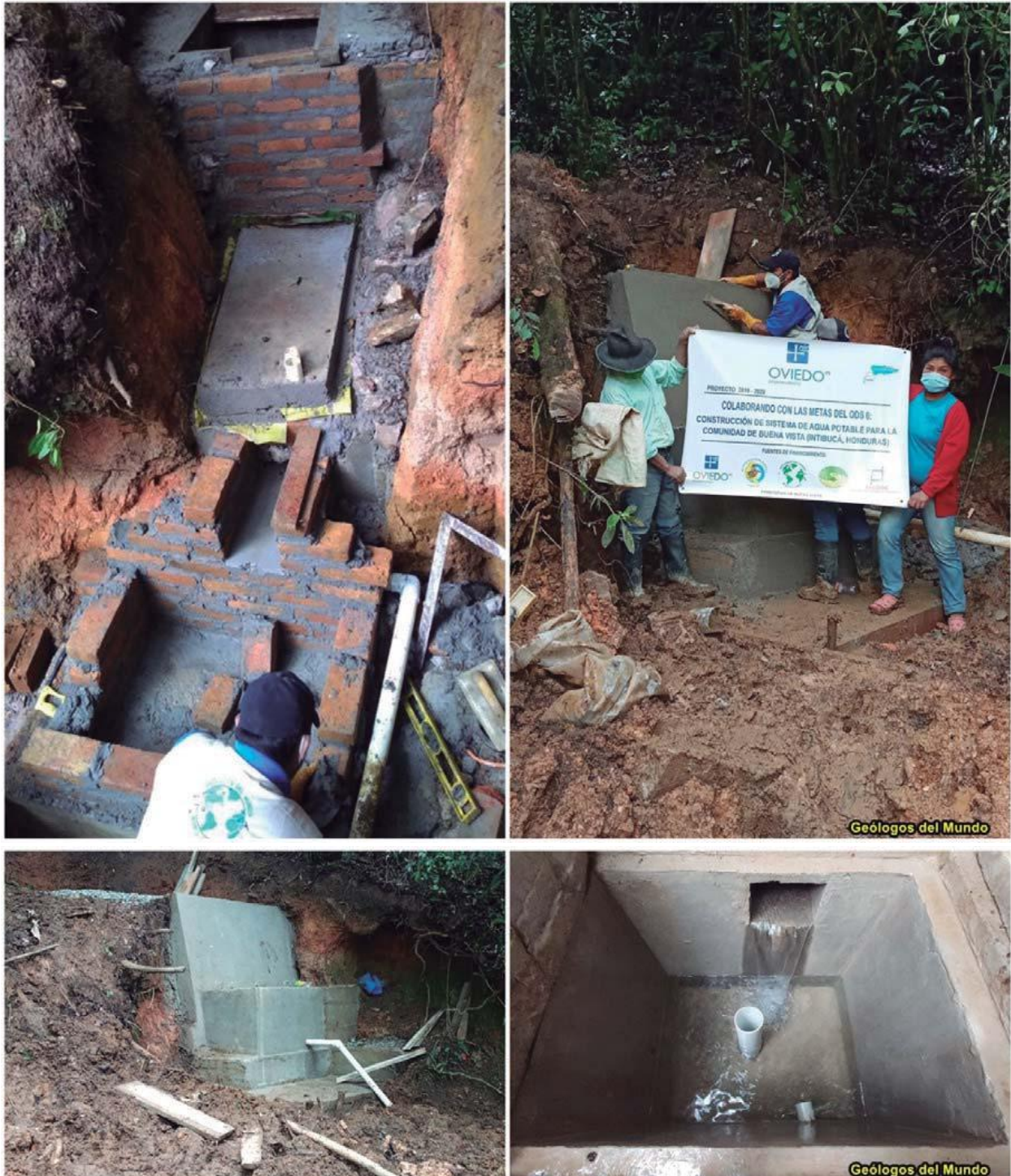
Figura 17.- Obra toma en construcción y una vez finalizada y en funcionamiento. Aforo de la fuente 13 gal/min
