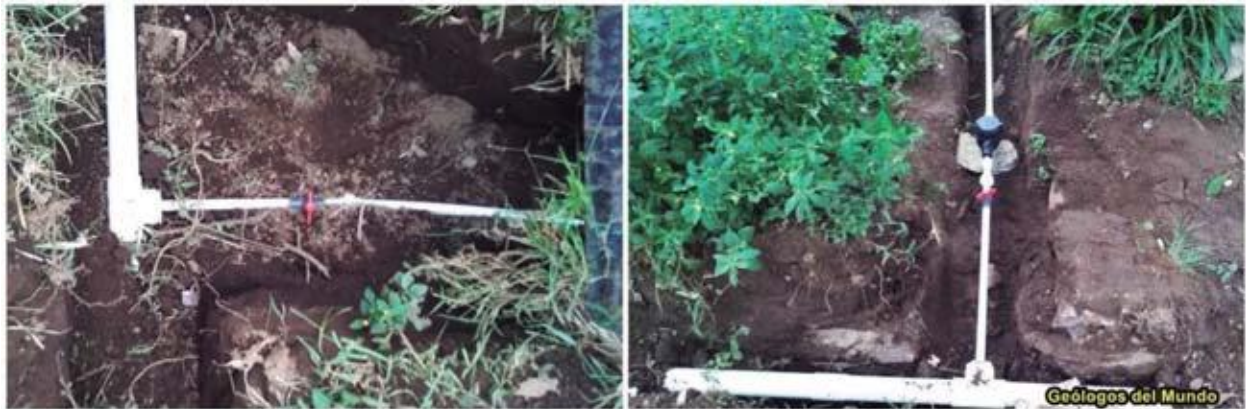
Figura 35.- Derivaciones de acometidas domiciliarias mediante tubo PVC de ½ pulgada de diámetro. Cada acometida conlleva una válvula de paso y el correspondiente micromedidor.
