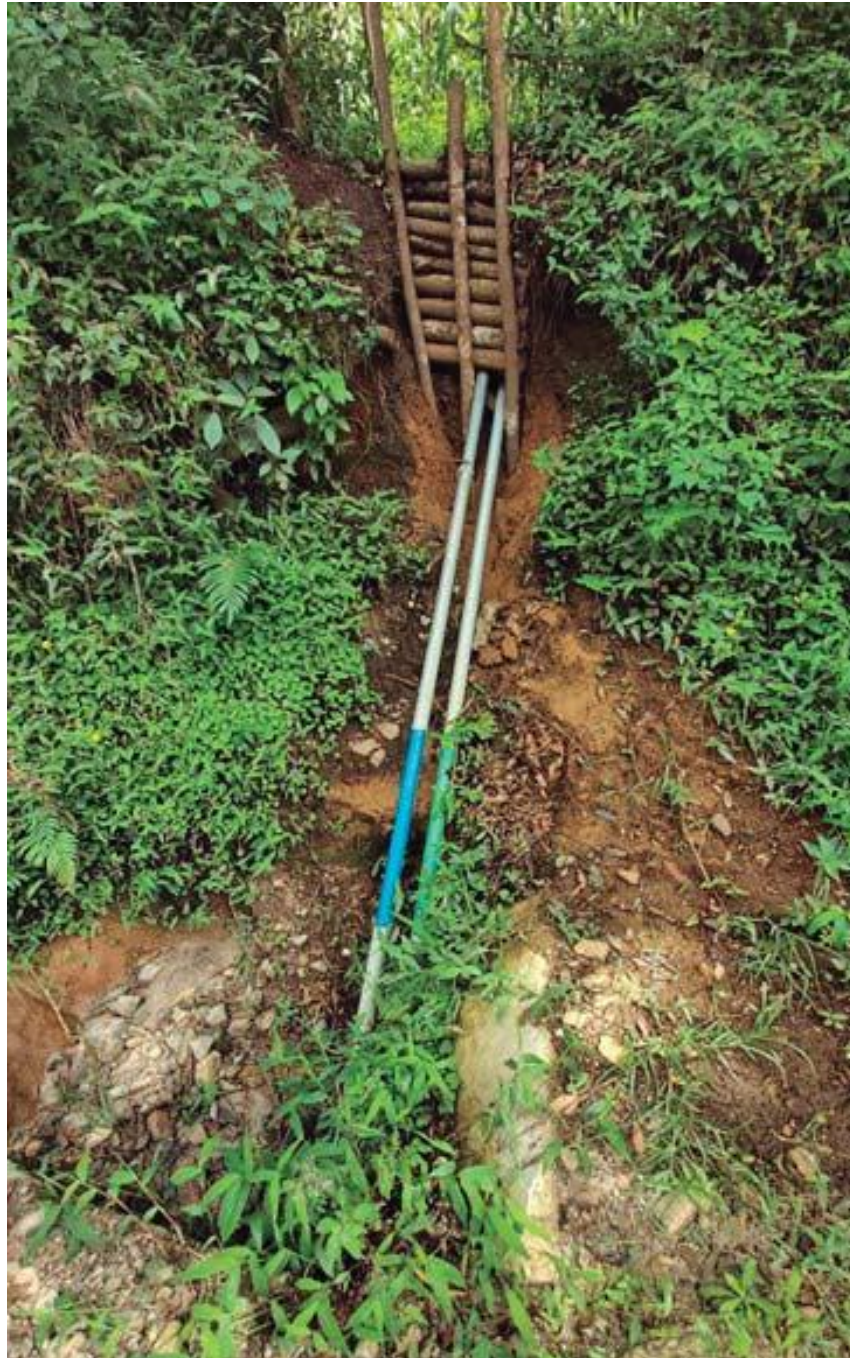
Imagen 6: Tubería de impulsión, de color verde, y de distribución, de color azul.
