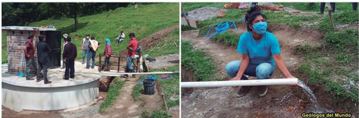
Figura 25.- Momento de la prueba de funcionamiento de la bomba. La bomba ha de superar una diferencia de cotas de 68 metros.
