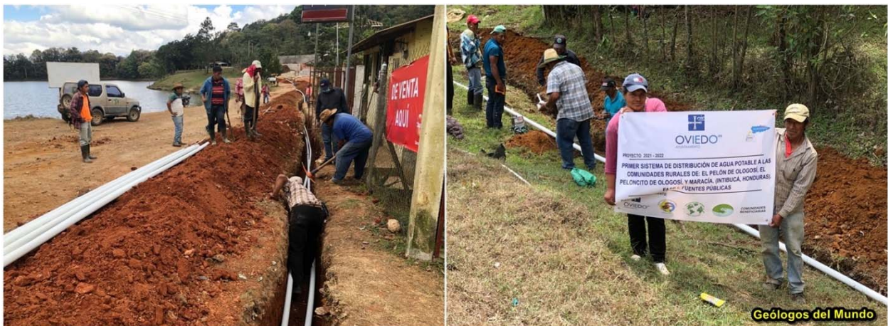
Figura 23.- Instalación de tubería de 2 pulgadas. De observa que en este tramo el número de tuberías en zanja es de dos (2); ya quedó servida una de las comunidades (El Pelón de Ologosí) y las líneas continúan hacia las otras dos comunidades (El Peloncito Ologosí y Maracía).
