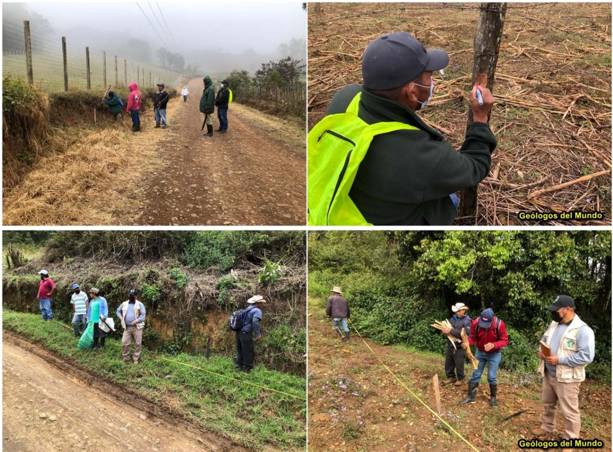
Figura 11.- Labores de replanteo en terreno de la traza de las líneas de distribución y emplazamiento de fuentes comunitarias. Estas labores se realizaron con medición mediante cinta y el estaquillado de la traza.
