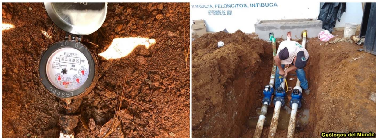
Figura 30.- Micromedidores instalados (14) en las acometidas a las fuentes comunitarias. A la derecha, instalación de los tres macromedidores en sus correspondientes salidas del depósito.
