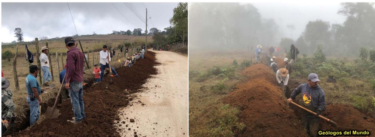
Figura 12.- Labores de apertura de zanja. Las zanjas, siempre que es posible, se abren en los bordes de los caminos y calles públicas para evitar atravesar propiedades privadas. Se realizaron en su práctica totalidad con excavación manual con la activa participación de los propios beneficiarios.
