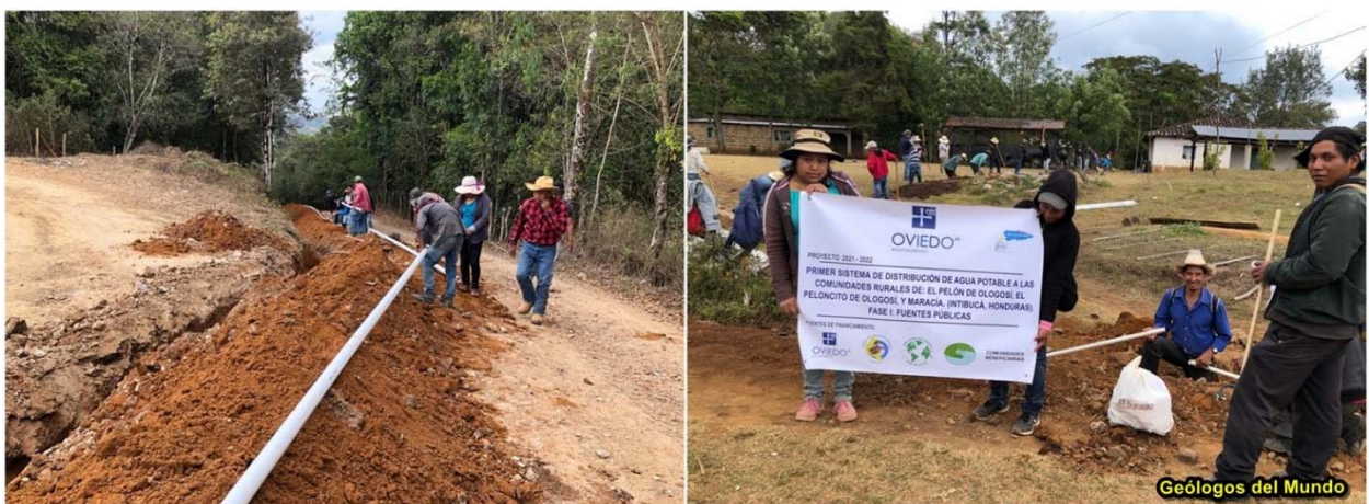
Figura 26.- Instalación de tubería de distribución a una comunidad. A la derecha derivación hacia una de las fuentes comunales dentro de un núcleo poblado.
