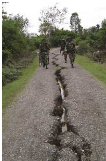
Grieta producida por un terremoto. Sumatra
