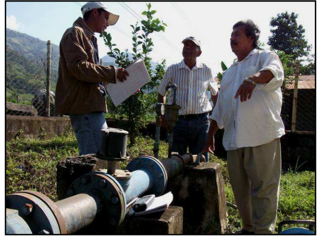
Pozo Profundo en la colonia San Jorge.
