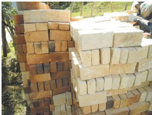
Acopio de los ladrillos para la construcción del depósito. Se comprueba que algún lote presenta una cocción deficiente (ladrillos de color casi blanquecino), mientras que en otros se manifiesta una cocción excesiva (ladrillos de color negruzco).
