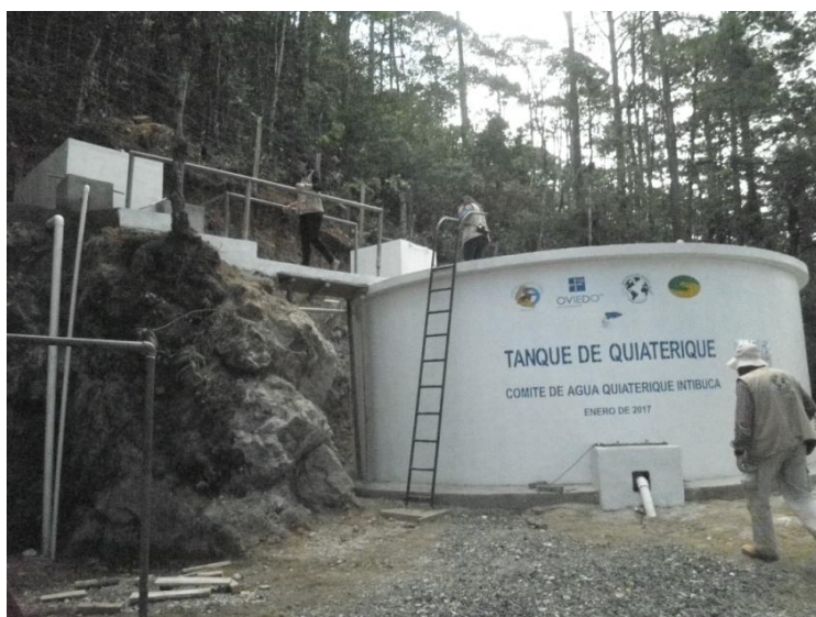
Tanque y caja filtro, ambos comunicados mediante una pasarela elevada. Proyecto de Quiaterique.
